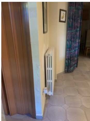
28. particolare : termosifone in ghisa
