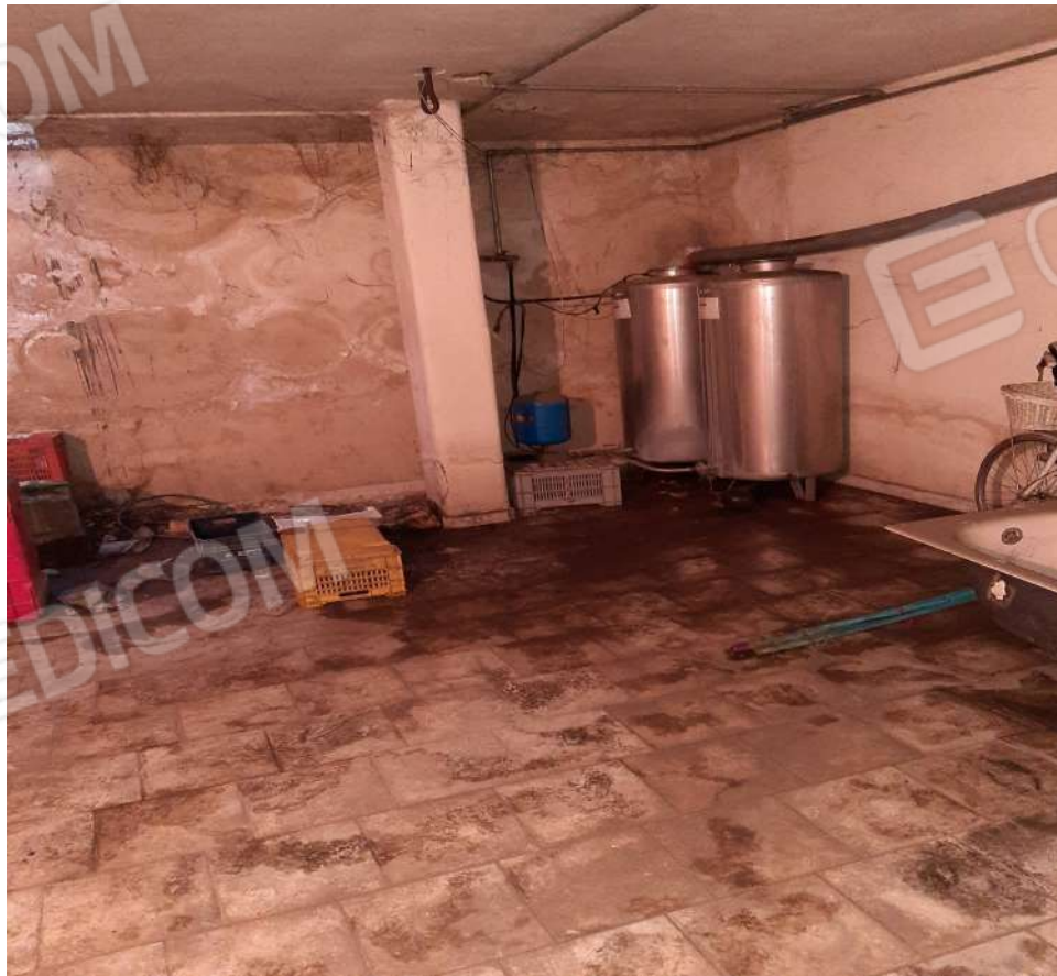
Foto n. 25/2 vista interna zona autoclave P.S.1.
