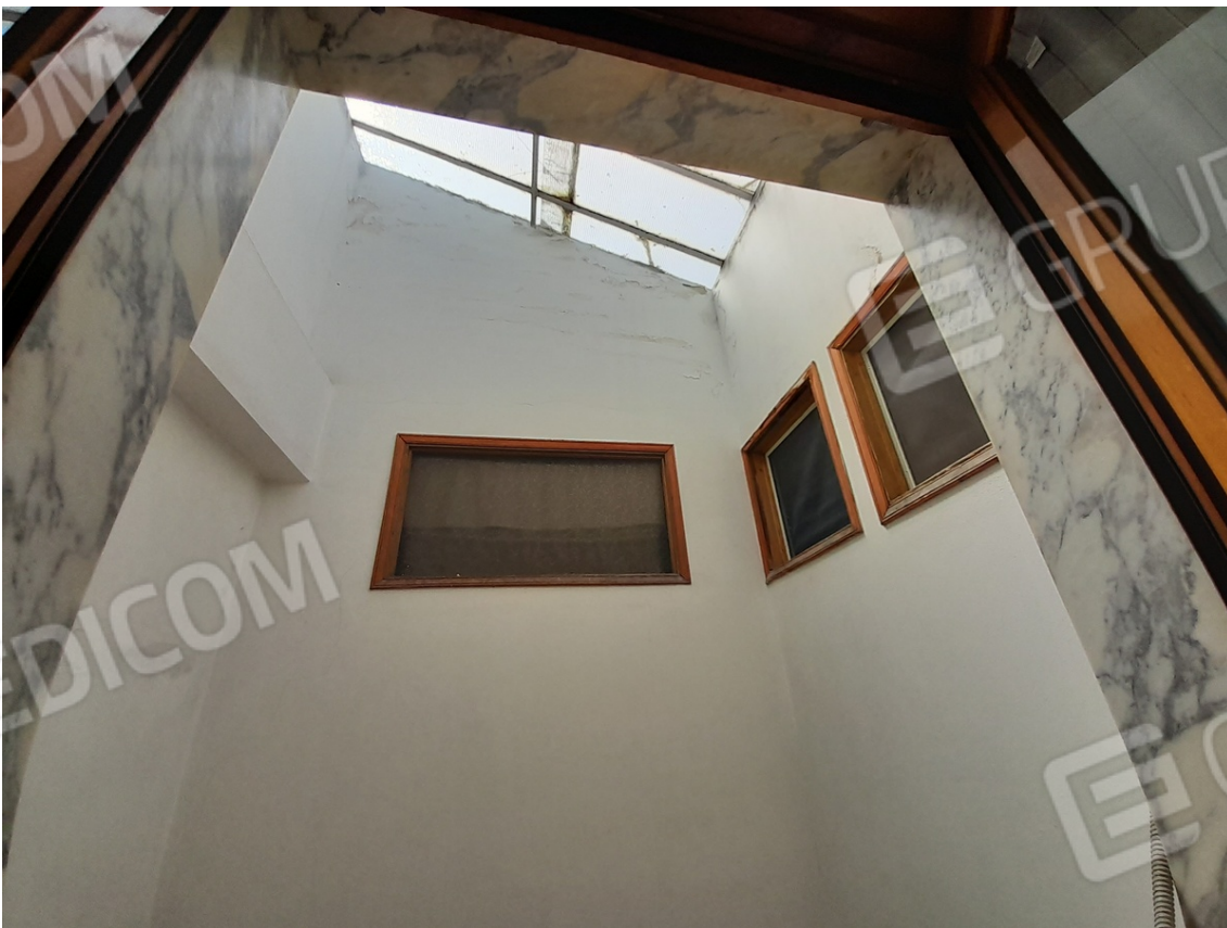
F. 24 – Pozzo luce
