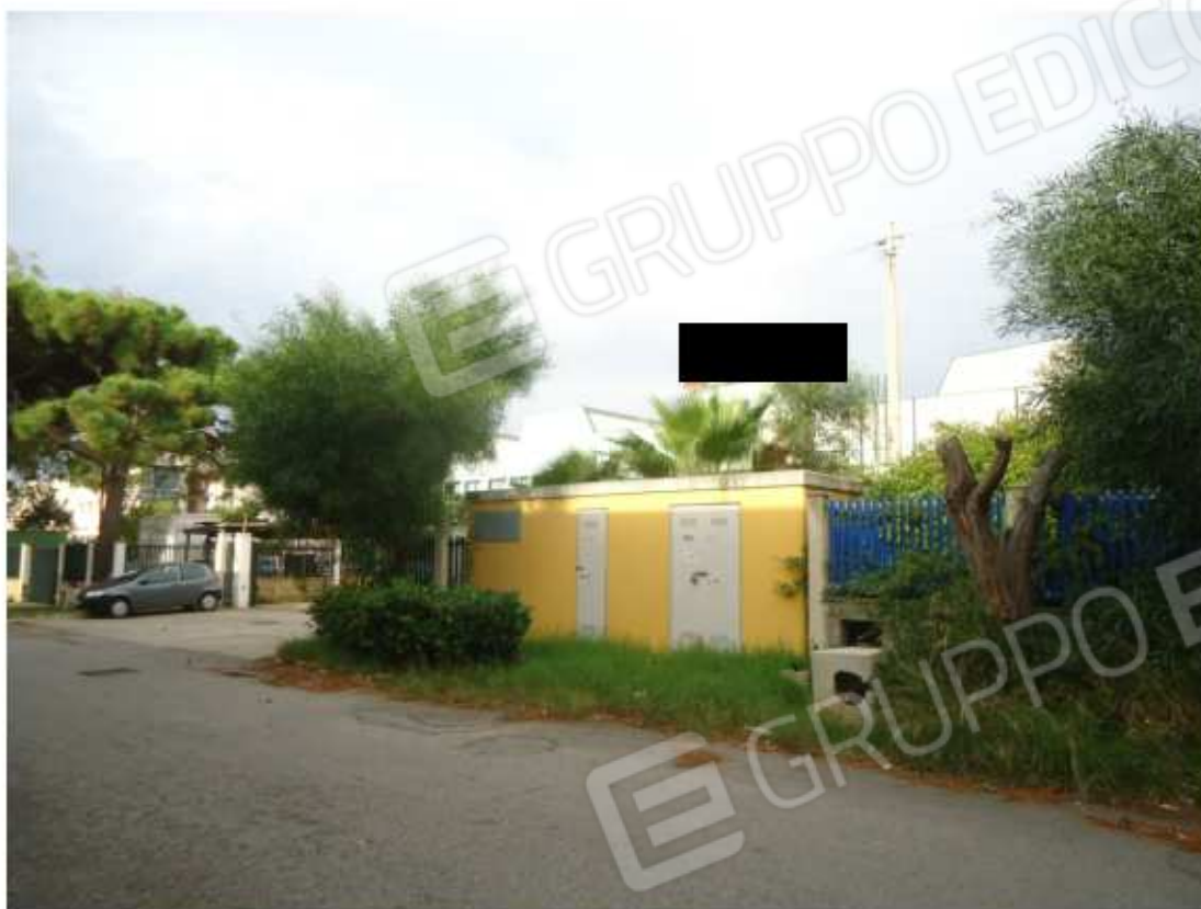
FOTO n. 29: Cabina elettrica mt/bt
