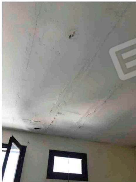
foto n. 12 condizioni del soffitto
