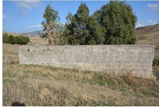
Foto 20 (Allegato 10) Magazzino P.lla 744 del Fg. 13
