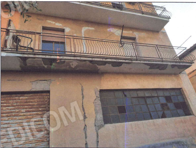
Foto 8 - I balconi sono degradati con mancanza di intonaco e calcestruzzo copriferro, causati da infiltrazioni d'acqua. Anche il prospetto presenta l'intonaco danneggiato da macchie di umido e da dilavamento. Occorrono lavori di manutenzione straordinaria.
