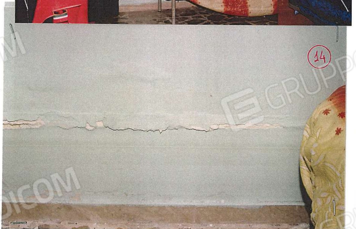
DANNI DA UMIDITA'
