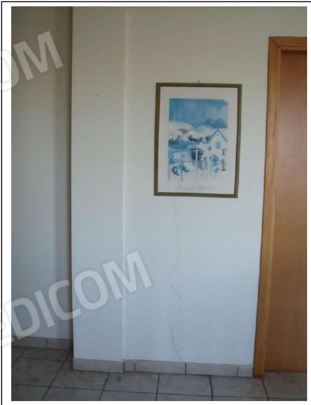
72. Interno "zona disimpegno" dell'unità immobiliare al piano primo, con vista lato nord-ovest, in foto lesione verticale intonaco in prossimità di pilastri con giunto strutturale.
