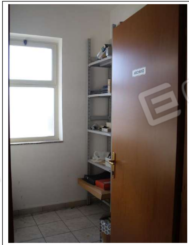
56. Interno "archivio" dell'unità immobiliare al piano primo, con vista lato nord, in foto sufficiente stato di manutenzione.
