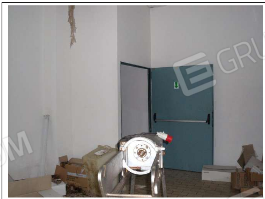
21. Interno “deposito cartoni” dell’unità immobiliare al piano terra, con vista lato sud, in foto insufficiente stato di manutenzione.
