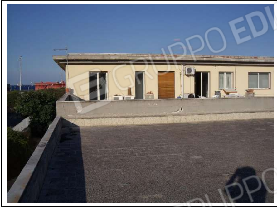
85. Esterno “terrazza praticabile” dell’unità immobiliare al piano primo, con vista lato nord-est, in foto cattivo stato di manutenzione.
