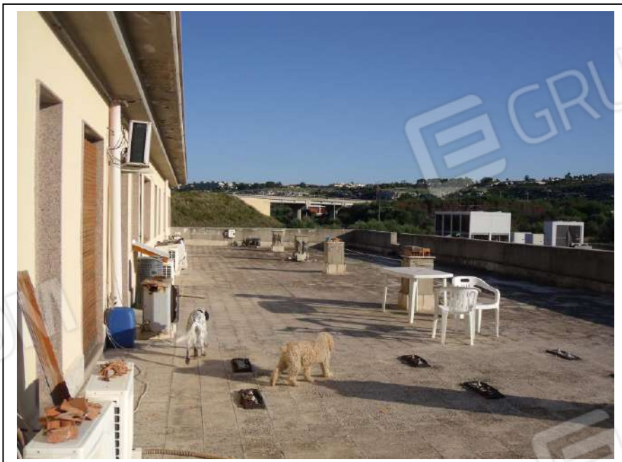
84. Esterno “terrazza praticabile” dell’unità immobiliare al piano primo, con vista lato sud-est, in foto cattivo stato di manutenzione.
