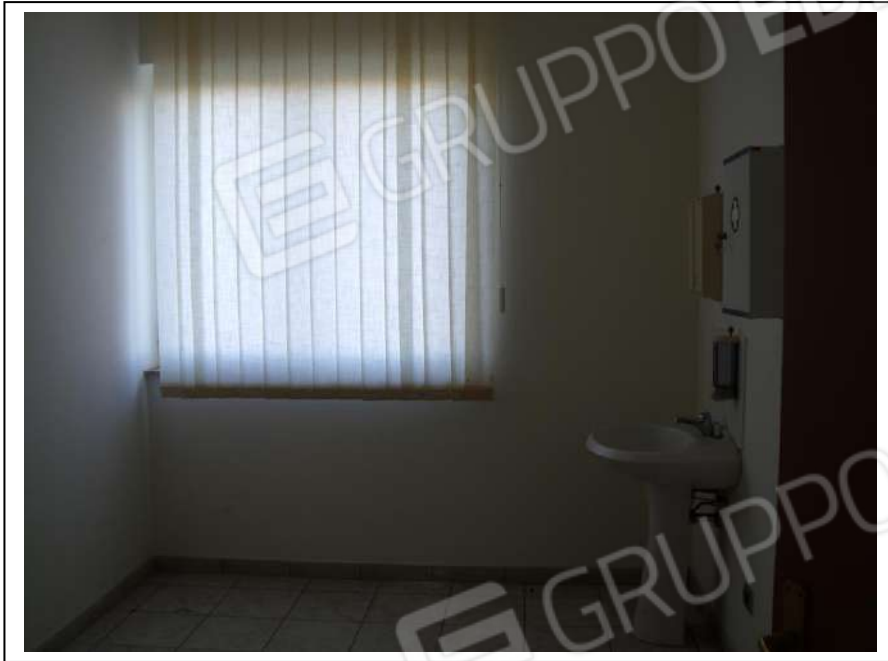
45. Interno "infermeria" dell'unità immobiliare al piano primo, con vista lato nord-est, in foto buono stato di manutenzione.
