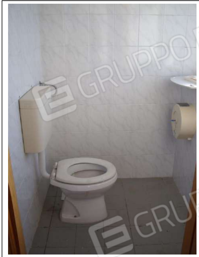
49. Interno “servizio igienico spogliatoio donne” dell’unità immobiliare al piano primo, con vista lato sud-ovest, in foto sufficiente stato di manutenzione.
