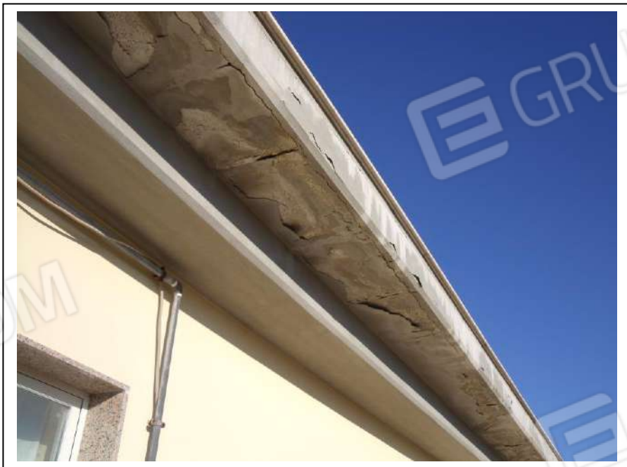
88. Esterno “terrazza praticabile” dell’unità immobiliare al piano primo, con vista lato nord-est, particolare linea di gronda del tetto, in foto cattivo stato di manutenzione.
