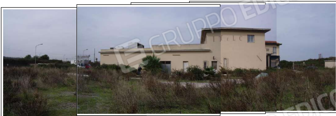
03-04-05-06. Prospetto laterale con esposizione a sud-est su area di pertinenza dell'immobile, presenza di vegetazione spontanea su area non asfaltata.
