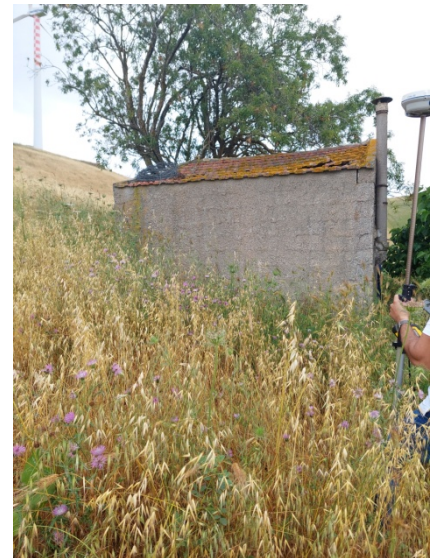
Foto 26 - Manufatto su p.lla 175
