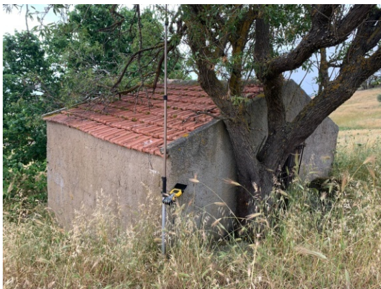
Foto 21 - Manufatto su p.Illa 175
