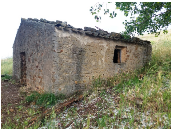
Foto 19 – Manufatto su p.lla 173
