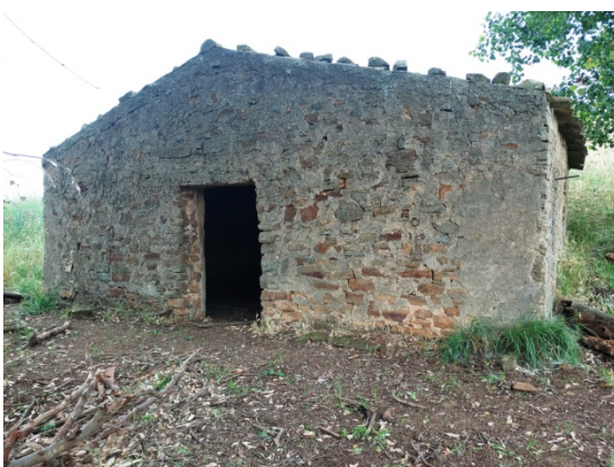
Foto 17 – Manufatto su p.lla 173
