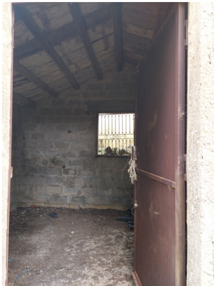
Foto 25 - Manufatto su p.lla 175
