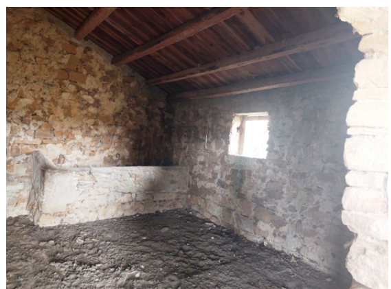
Foto 18 – Manufatto su p.lla 173
