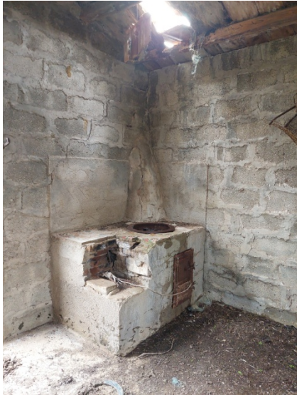
Foto 23 - Manufatto su p.lla 175
