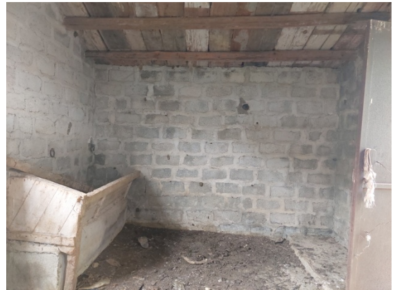
Foto 24 - Manufatto su p.lla 175
