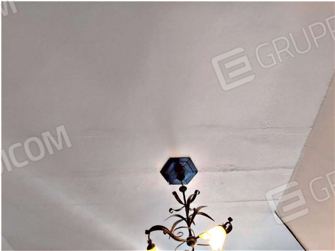
55 = Abitazione di 2°P – vano M (part. soffitto)
