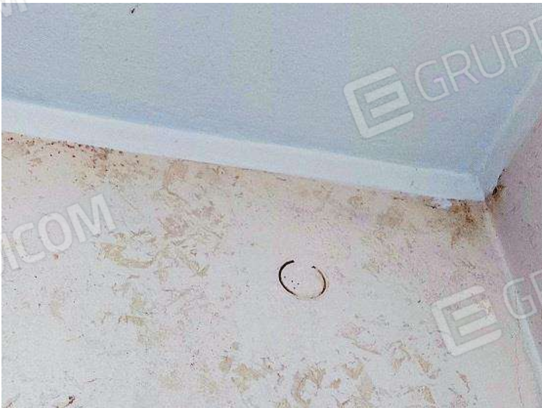
52 = Abitazione di 2°P – vano M (part. muffa)
