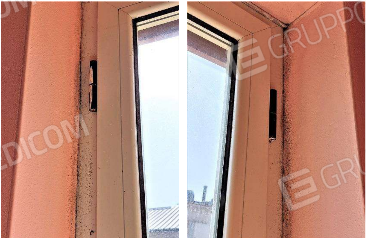
70 e 71 = Abitazione di 2°P – vano P (part. muffa)
