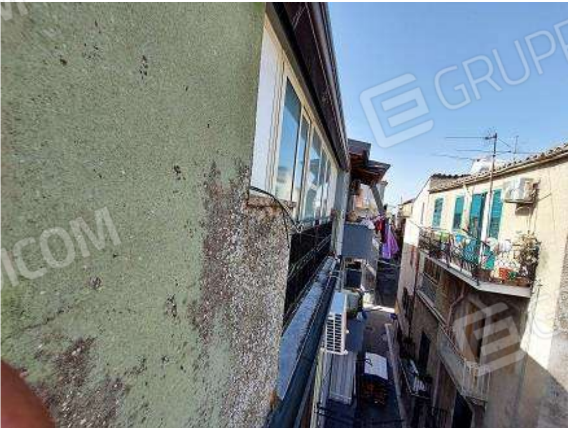
92 = Abitazione di 3°P – vano S (vista della veranda abusiva)
