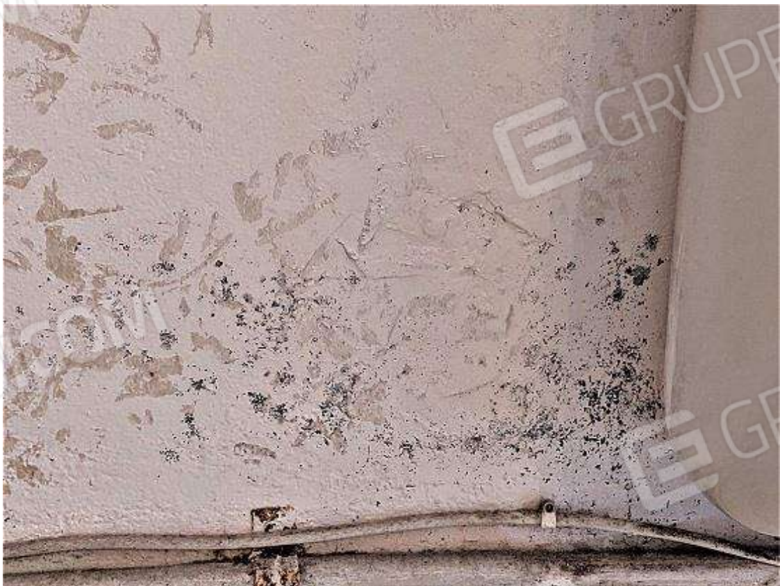
50 = Abitazione di 2°P – vano M (part. muffa)
