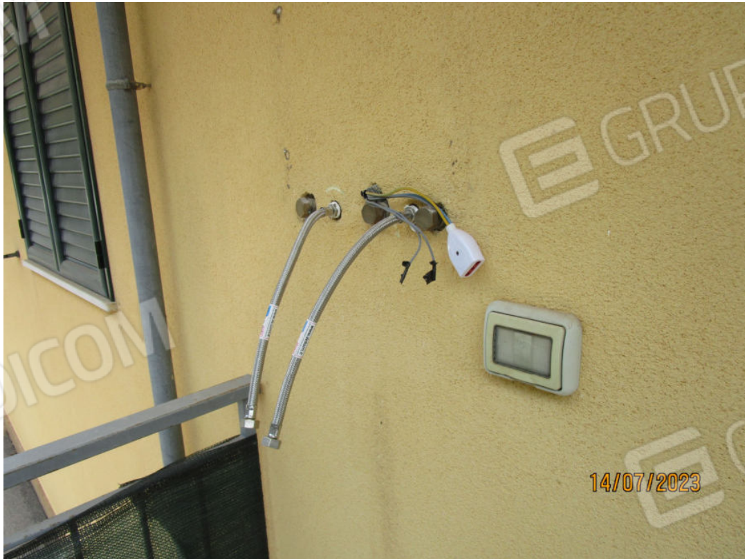
Foto 14 – Particolare attacchi caldaia
