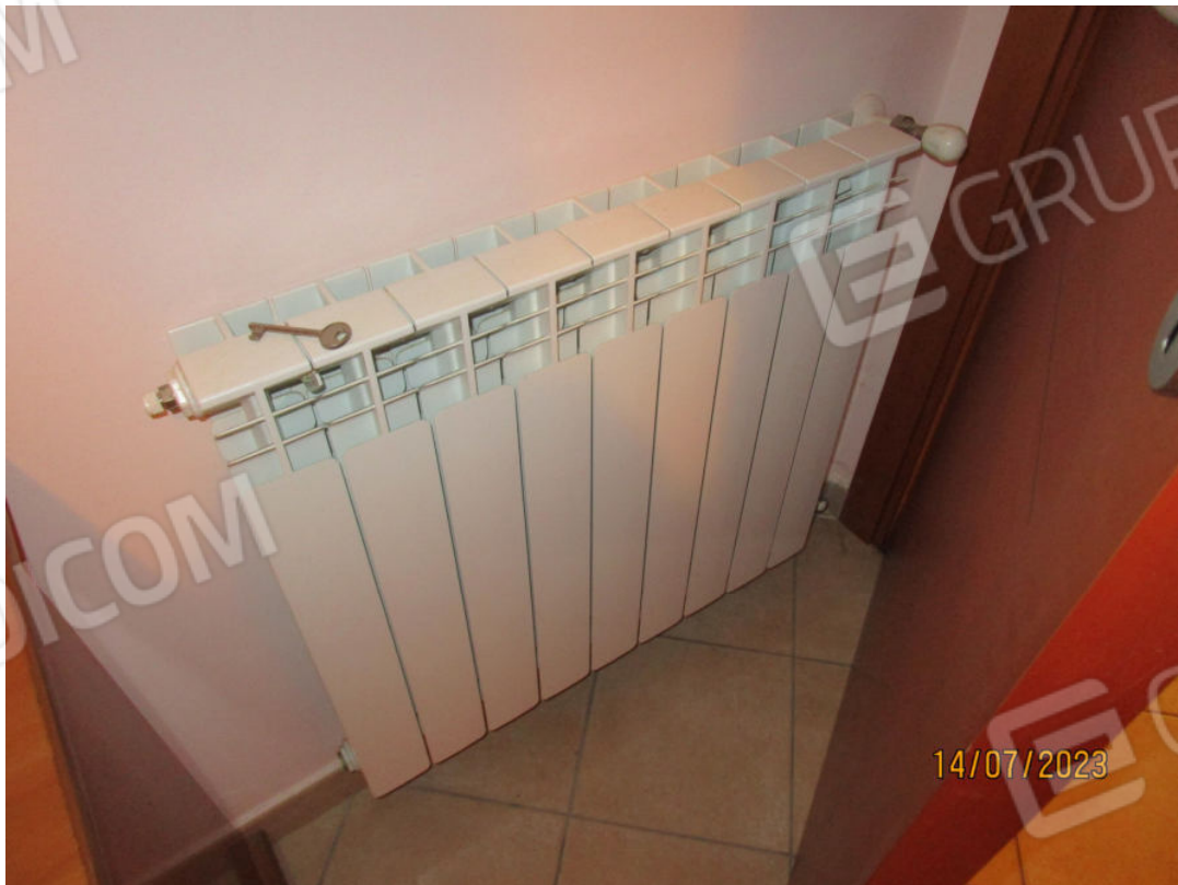
Foto 12 – Particolare piastre radianti
