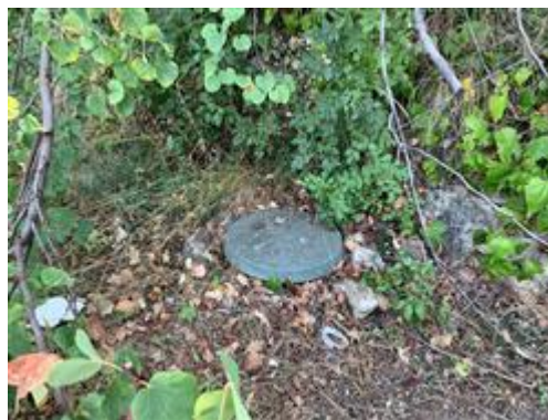
Serbatoio gpl interrato
