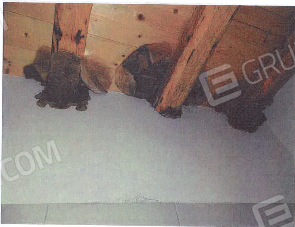
Foto n. 8 : C.F. Fg. 32 mapp. 212 sub 9 - Infiltrazioni di umidità e presenza di funghi
