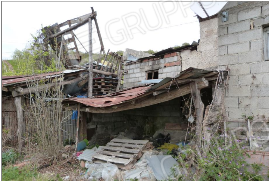
15 Vista di parte del prospetto sud del fabbricato sub 3; in primo piano, la tettoia ad uso legnaia quasi crollata.
