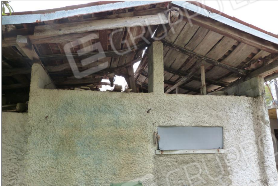
7 Vista della copertura in precarie condizioni statiche del corpo ad uso deposito del fabbricato sub 3.
