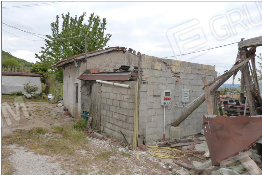
8 Vista dei prospetti nord ed ovest del fabbricato sub 3; si può notare che il deposito attrezzi è crollato.
