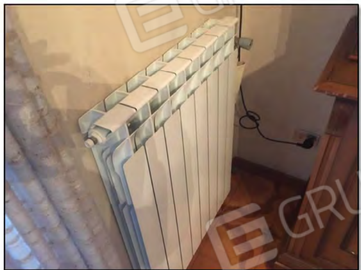
Figura 33- Particolare impianto termico
