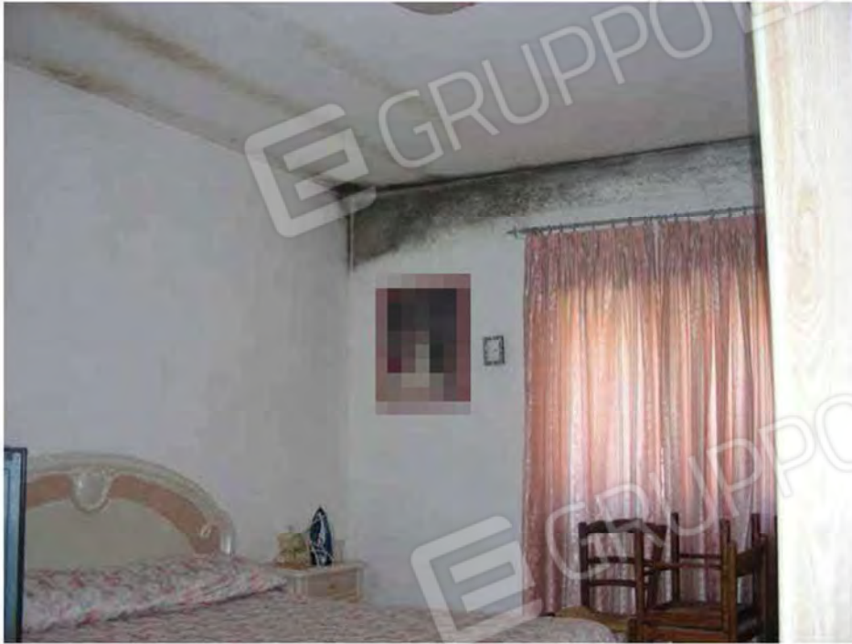
Foto 15 - Veduta della camera da letto matrimoniale con i fenomeni di condensa sulla parete lato est
