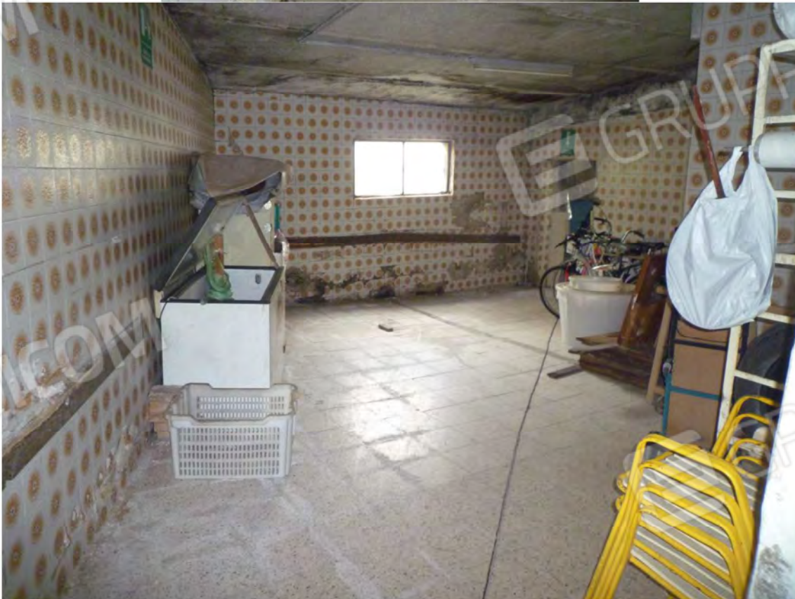
FOTO 32-33 deposito traccia di filo elettrico sul pavimento
