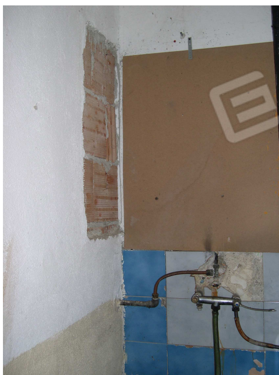
Foto 38 – Deposito-garage censito al foglio 4 part.IIa n. 124: tubi impianto idrico.
