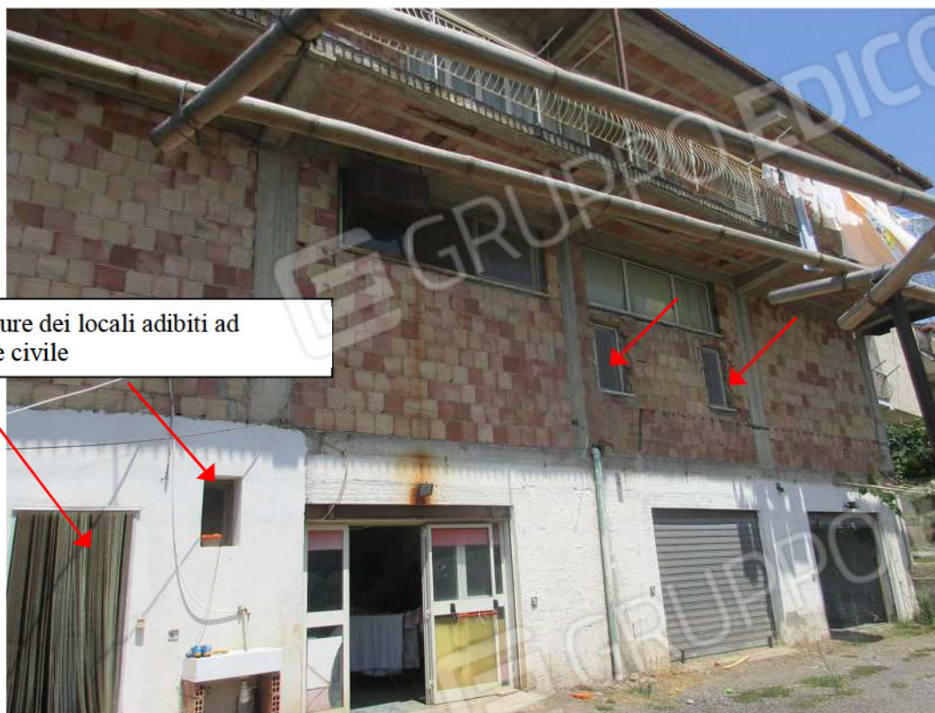
Foto 5 – Particolare prospetto est fabbricato: in evidenza le aperture abusive
