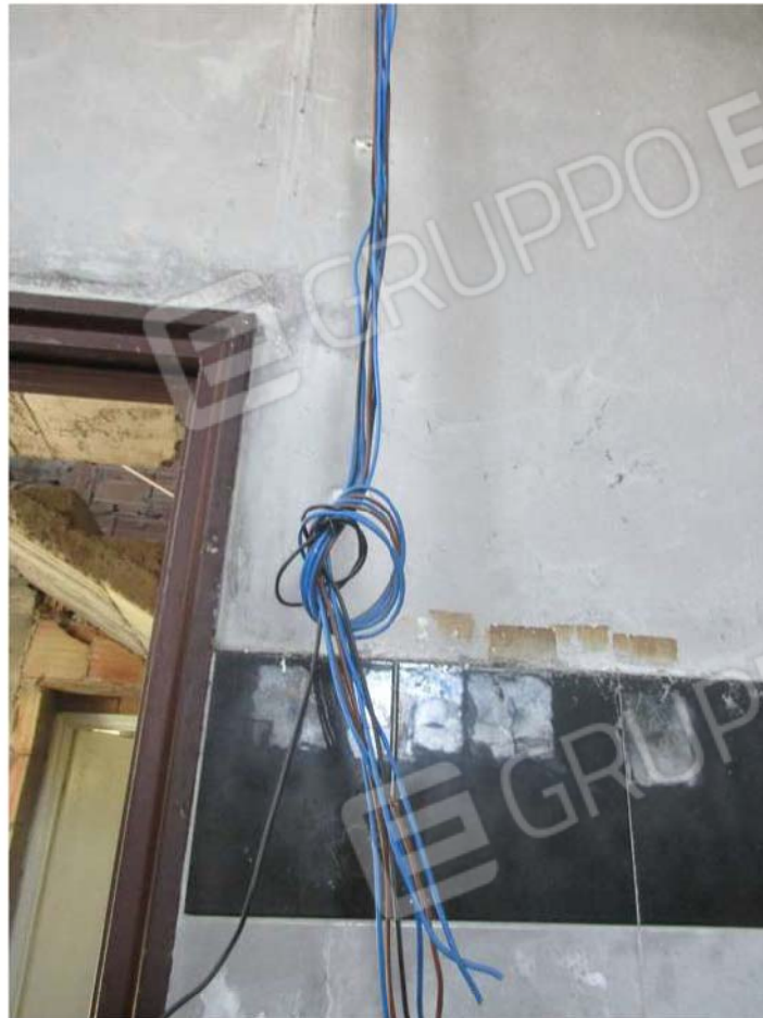
Foto 31: Altra immagine descrittiva dell'impianto elettrico
