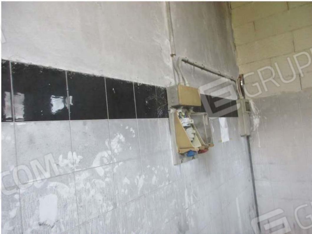
Foto 30: Immagine descrittiva dello stato dell'impiantistica elettrica
