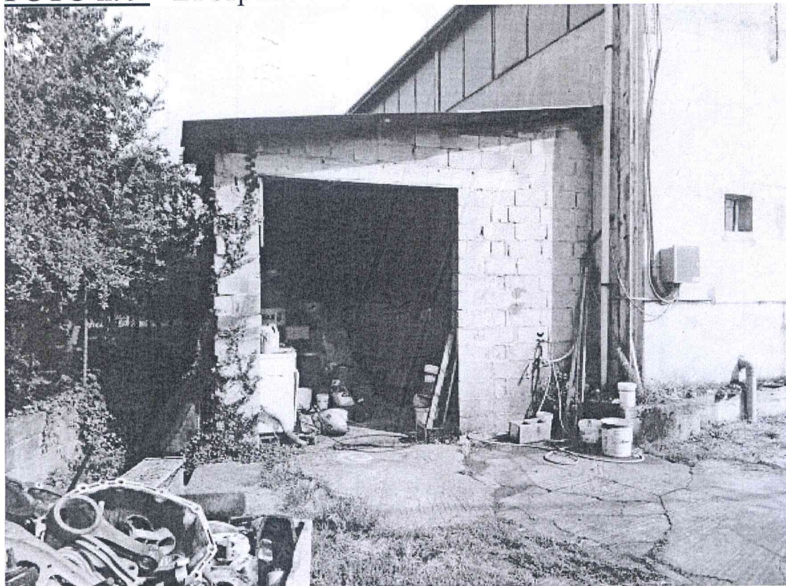
FOTO n. 9 La superfetazione adiacente alla struttura
