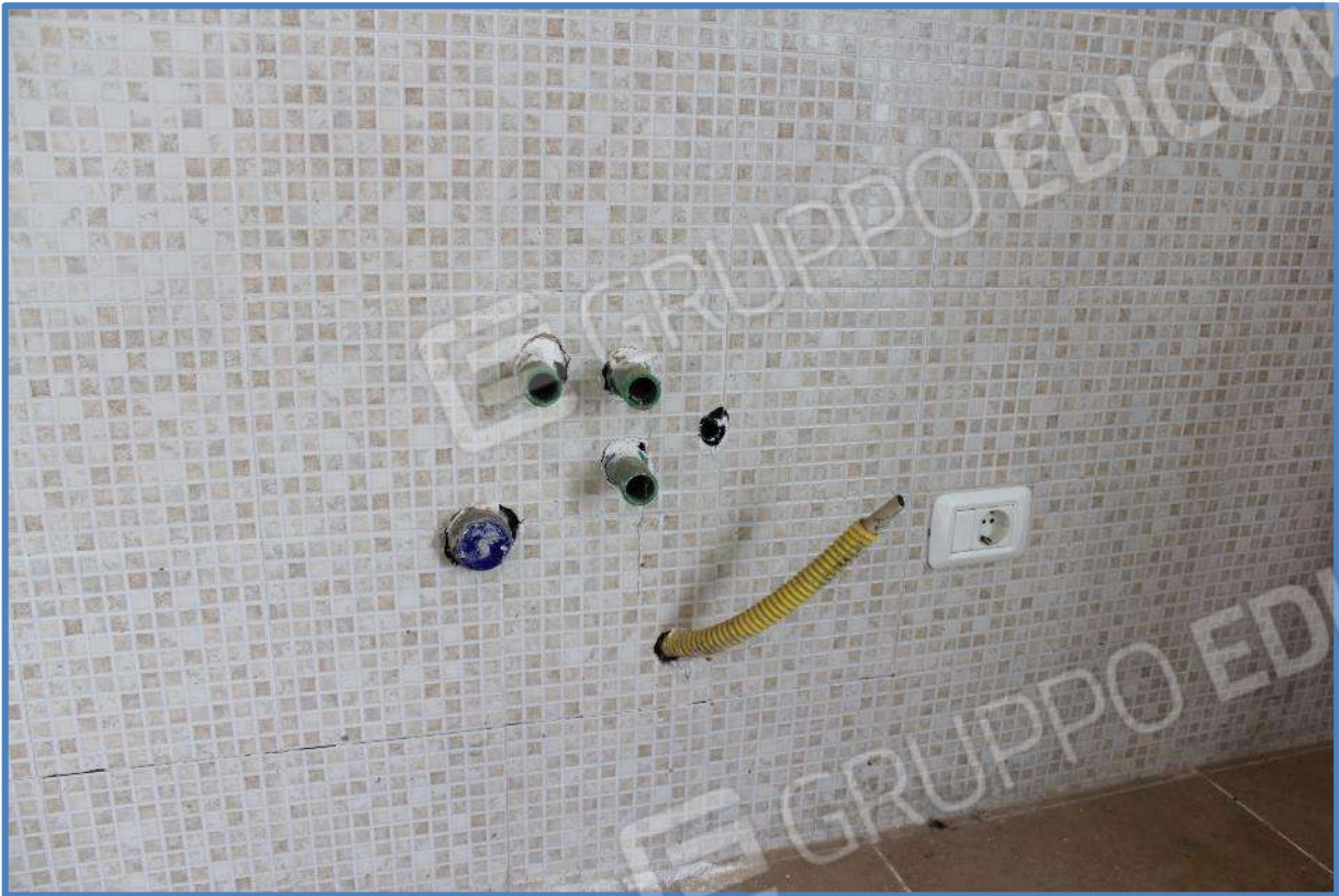
8.11- Zona giorno – Particolare degli attacchi per gli impianti, predisposti presso l'angolo cottura
