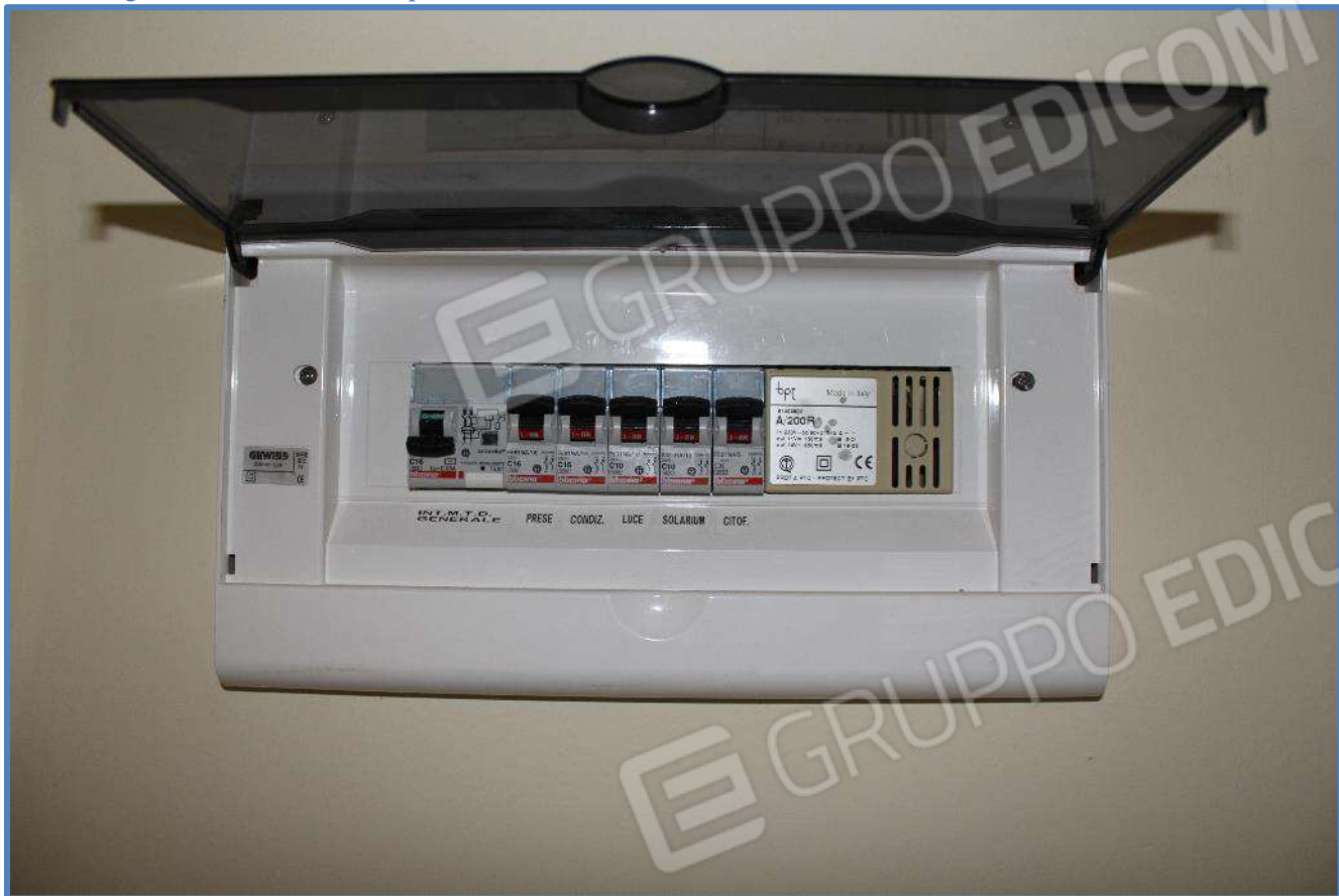
2.5- Zona giorno – Particolare su quadro elettrico, funzionante
