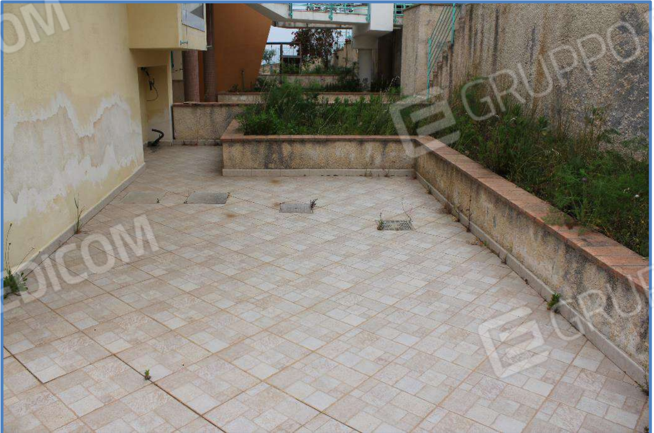
4.5- Porzione di corte di pertinenza esclusiva (p.lla 731/14) – Visibili i danni all'intonaco
