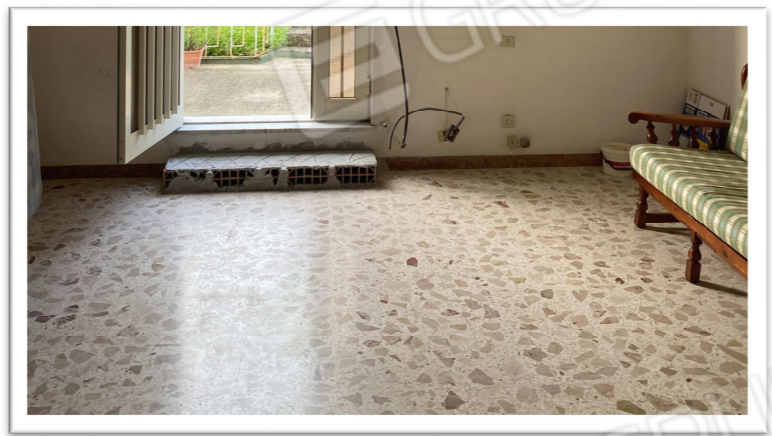
FOTO 32- PAVIMENTO IN GRANIGLIA DI MARMO
