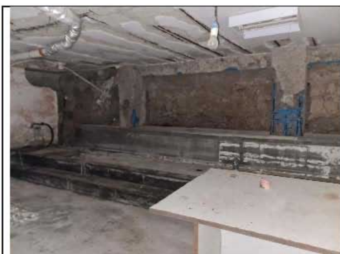
foto 47 – travetti del solaio NON trattati con evidenti stati di ossidazione – parete di fondo demolita ed interventi su pilastri appena accennati e NON portati a termine
