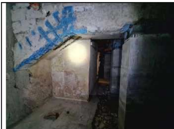
foto 50 – interventi su travi e scale NON portato a termine.
