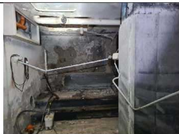
foto 51 – situazione della precaria parte impiantistica.
