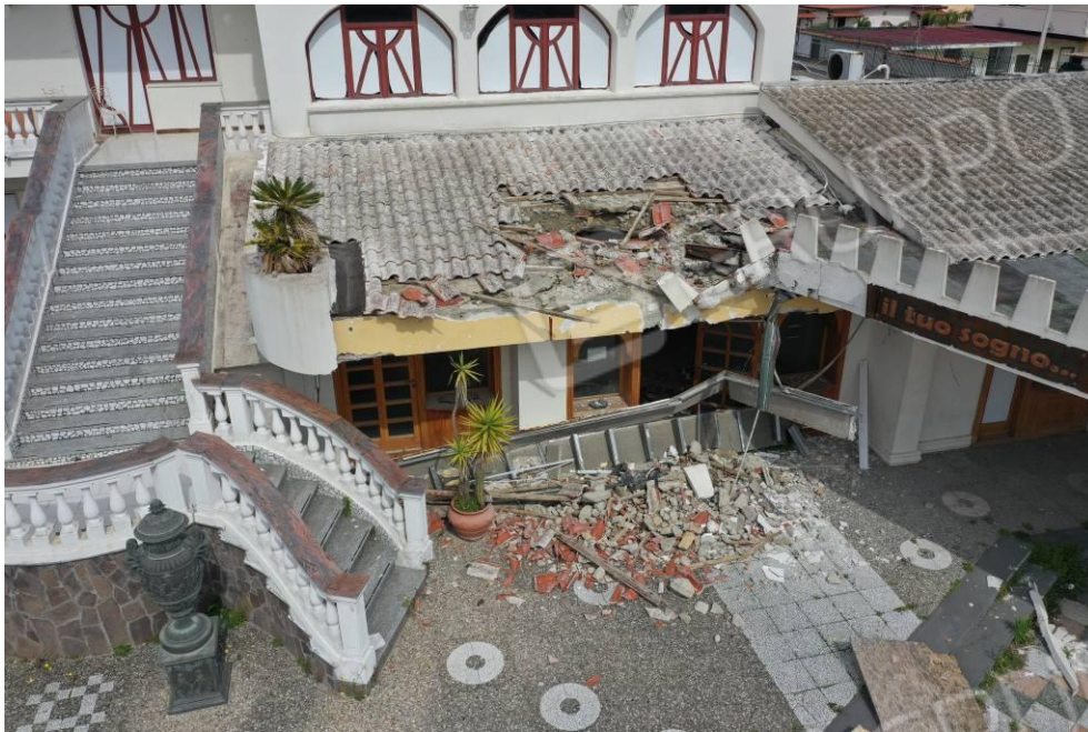
foto 12: particolare del crollo copertura ingresso.
