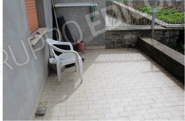
TERRAZZO CAMERA 2 IN PARTE NON REGOLARE, DA METTERE IN PRISTINO MEDIANTE DEMOLIZIONE
