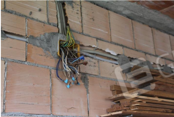
PARTICOLARE IMPIANTO ELETTRICO AL PIANO TERRA
