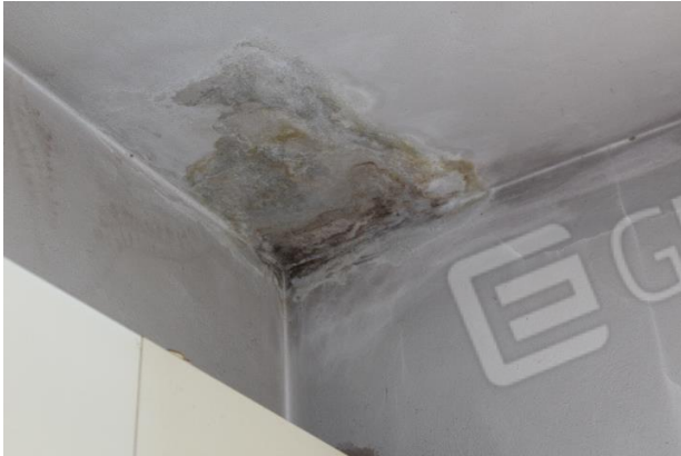
INFILTRAZIONE D'ACQUA ALLA CUCINA PIANO PRIMO
