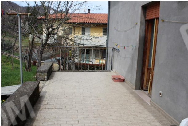
TERRAZZO CAMERA 2 IN PARTE NON REGOLARE, DA METTERE IN PRISTINO MEDIANTE DEMOLIZIONE
