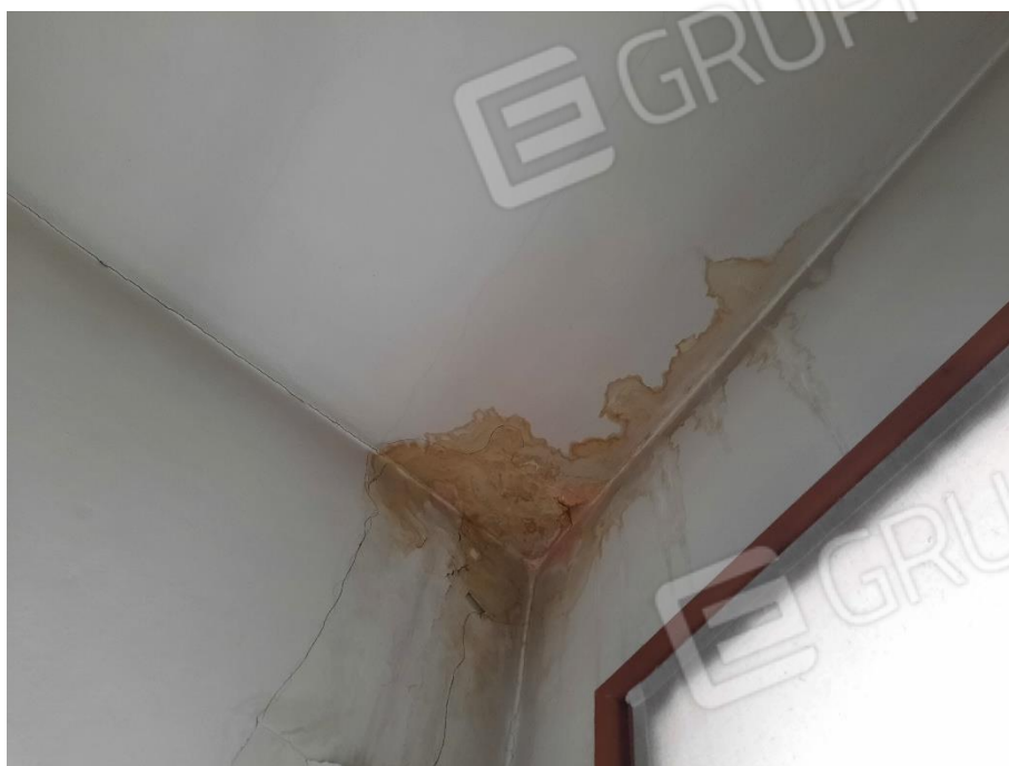
INFILTRAZIONI DAL SOFFITTO DEL BAGNO
