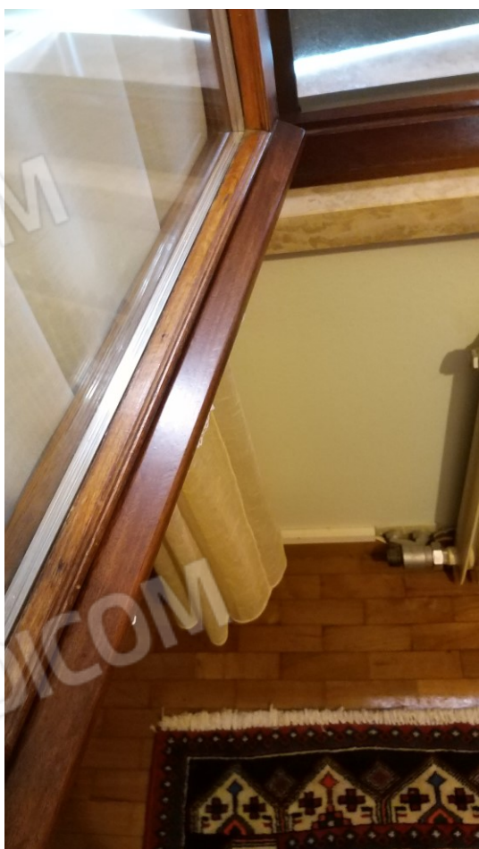
Foto n° 60 – Lotto 1 - Comune di Azzano Decimo (PN) – Foglio 19, m.le 496 sub 3 – Piano primo. Particolare dei serramenti nella camera di cui alla foto precedente.
