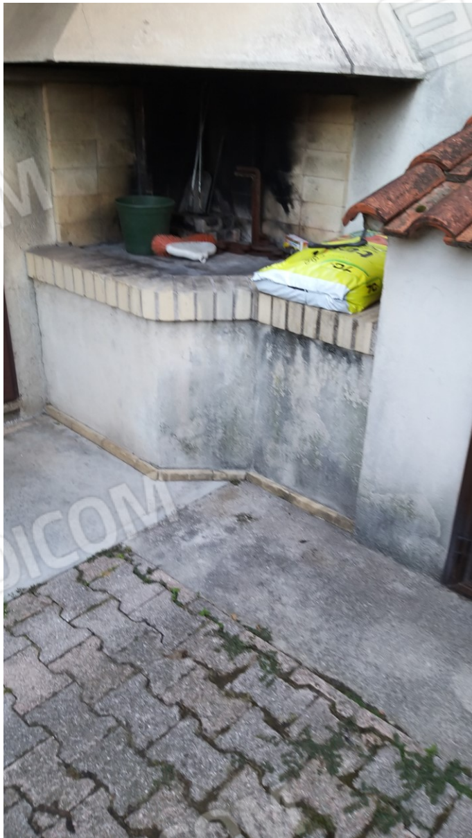
Foto n° 12 – Lotto 1 - Comune di Azzano Decimo (PN) – Foglio 19, m.le 496 sub 3. Particolare del caminetto esterno, posto a confine nord del compendio pignorato, nell'area adibita a barbecue.
