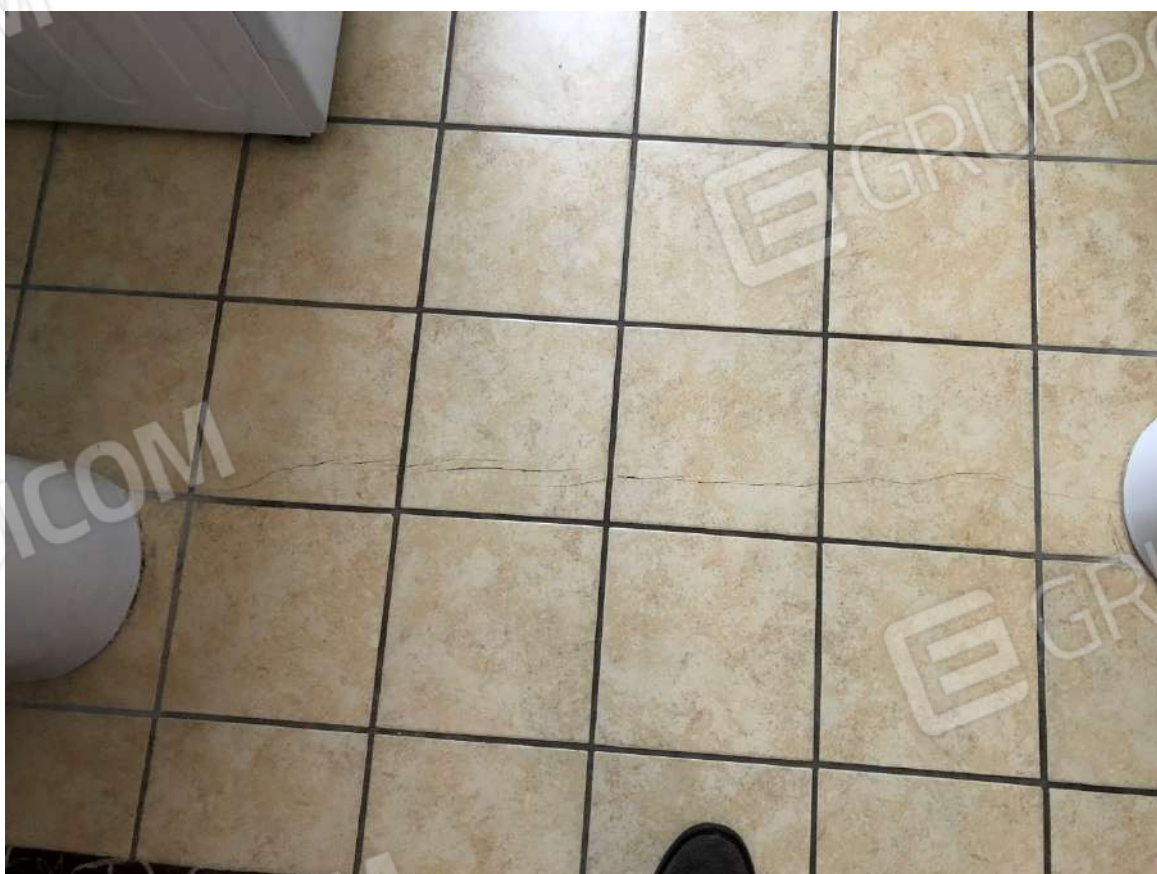
Foto n. 22 – I quadri fessurativi
