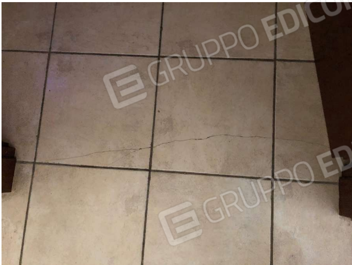
Foto n. 21 – I quadri fessurativi
