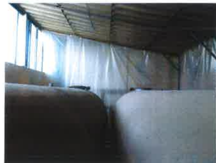
foto n. 24 (interno del capannone serbatoi)
