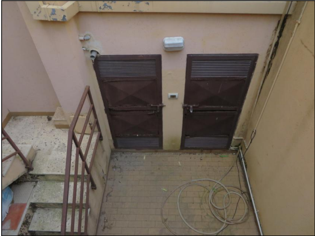
Locali tecnici ricavati al di sotto del piano seminterrato
