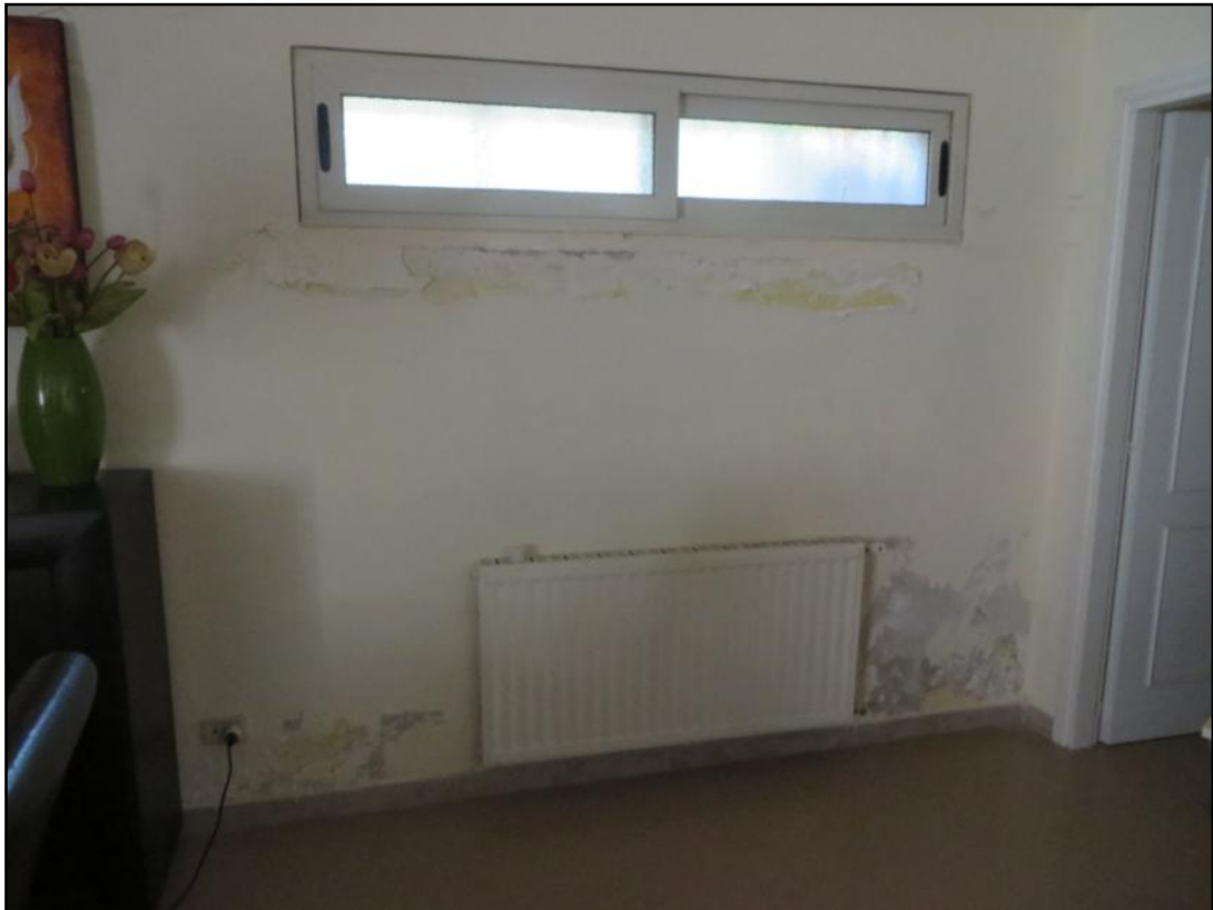
Ammaloramento della parete perimetrale (piano seminterrato)
