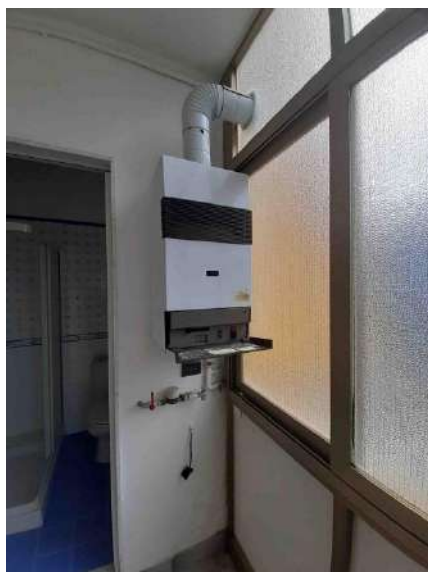
Foto 22 – Caldaia a metano
