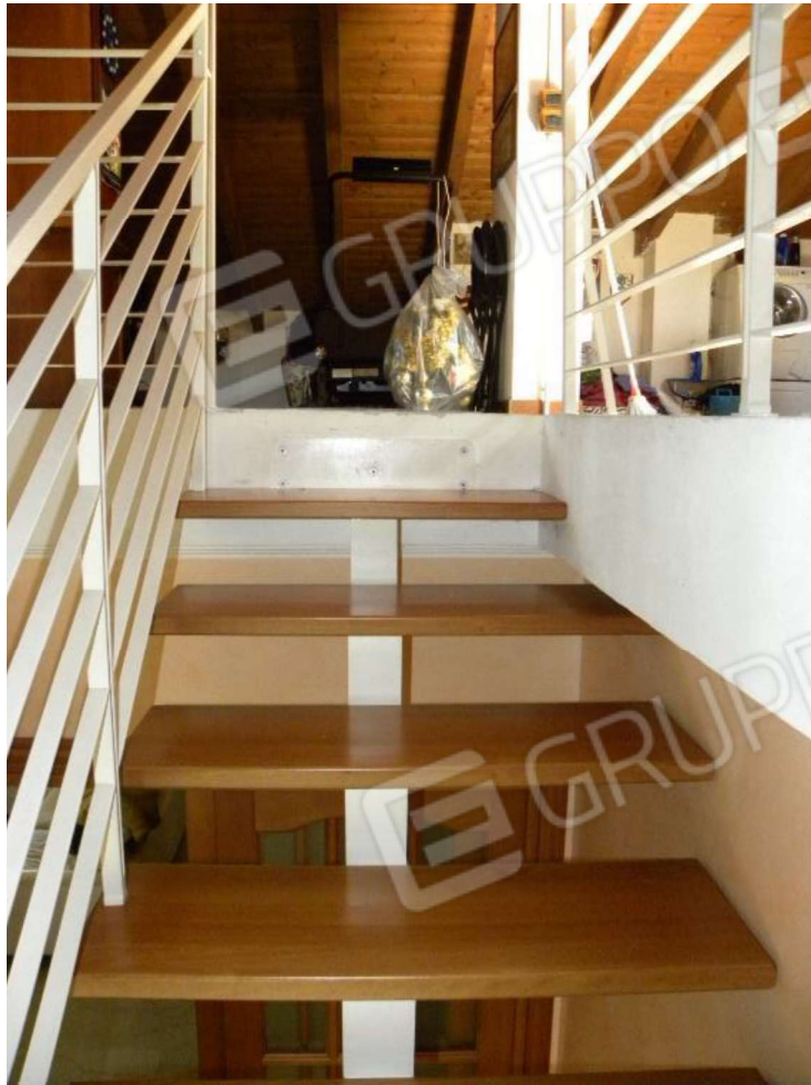
Scala di accesso al sottotetto – situazione da sanare
