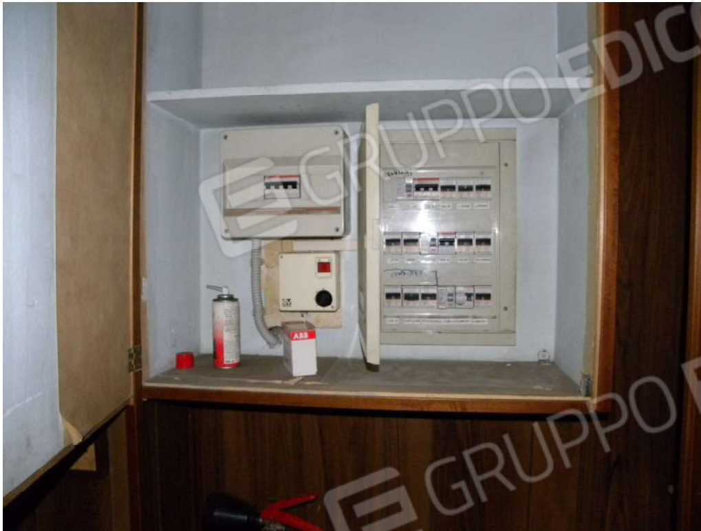
Dettaglio quadro elettrico
