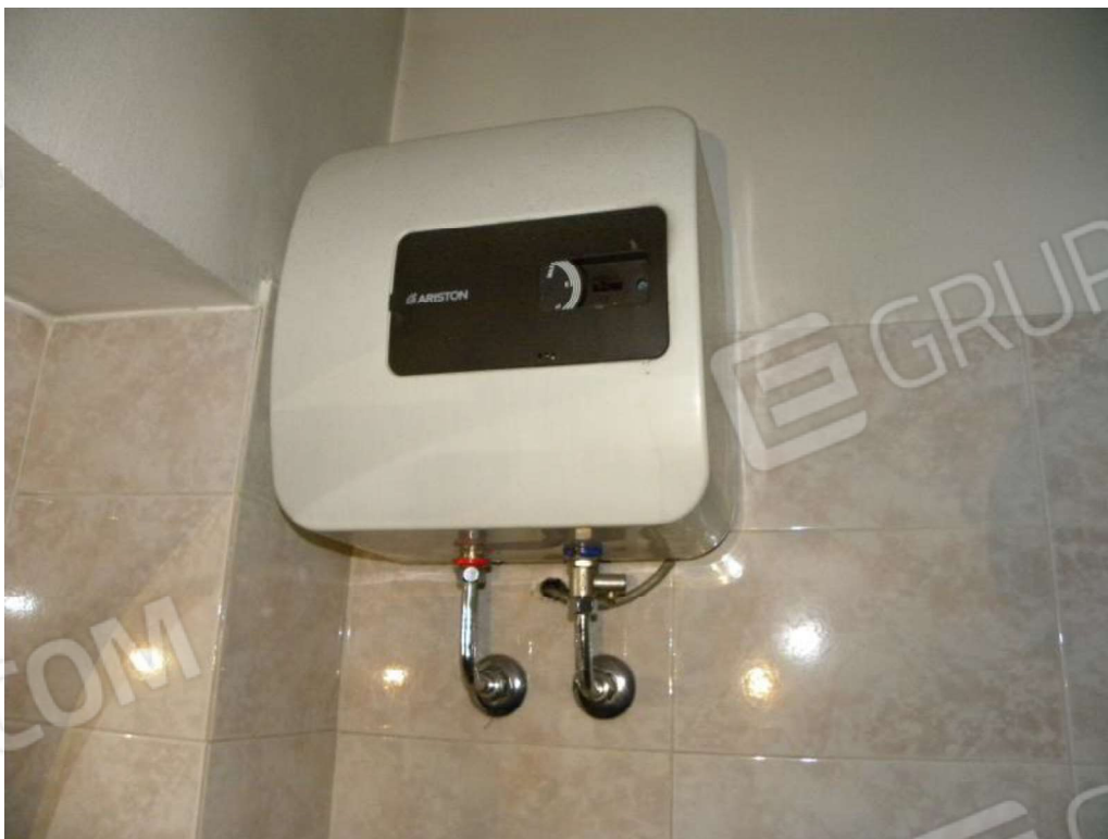
Dettaglio bollitore elettrico ad accumulo
