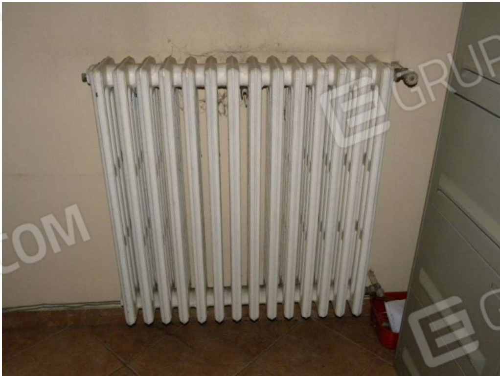
Dettaglio sistema emissivo riscaldamento
